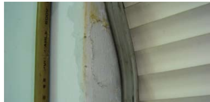
注意牆角、窗框的牆面，是否有水漬
